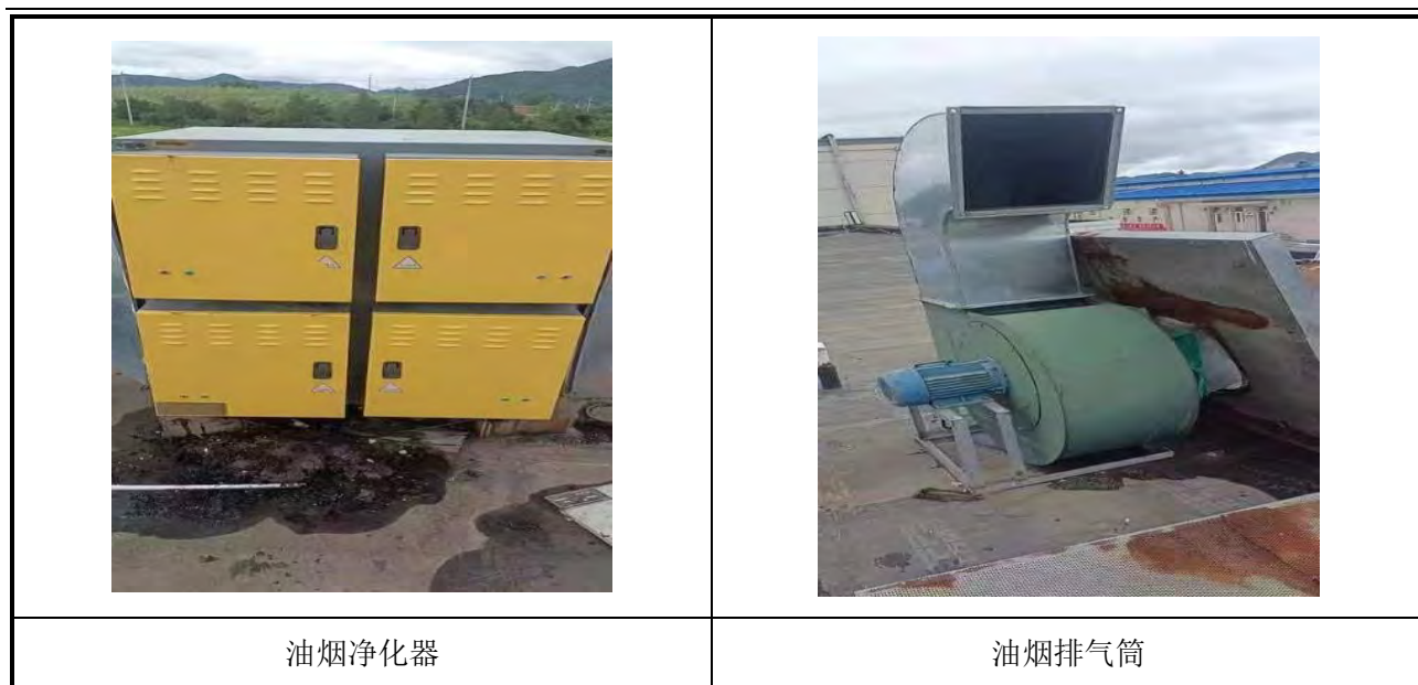
图 4.1-2 废气治理措施及排气筒照片
