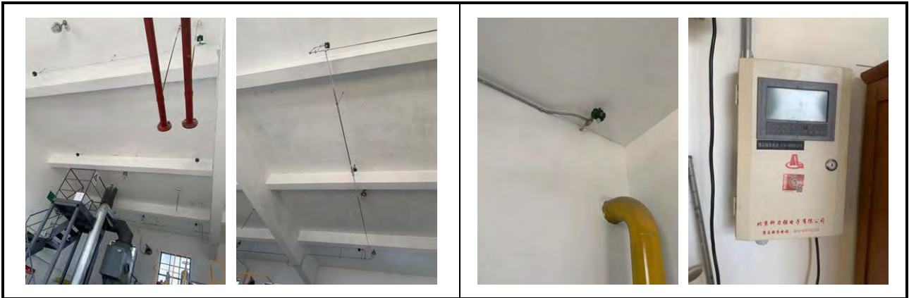
图 4.2-1 燃气泄漏检测报警装置
