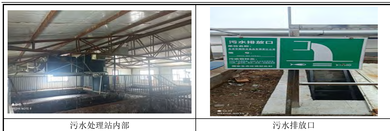
图 4.1-1 本项目废水治理设施照片
